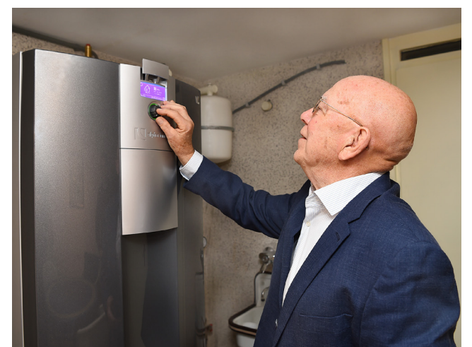
Wim Illem bij de warmtepomp die in de winter het huis verwarmt en in de zomer koelt.
